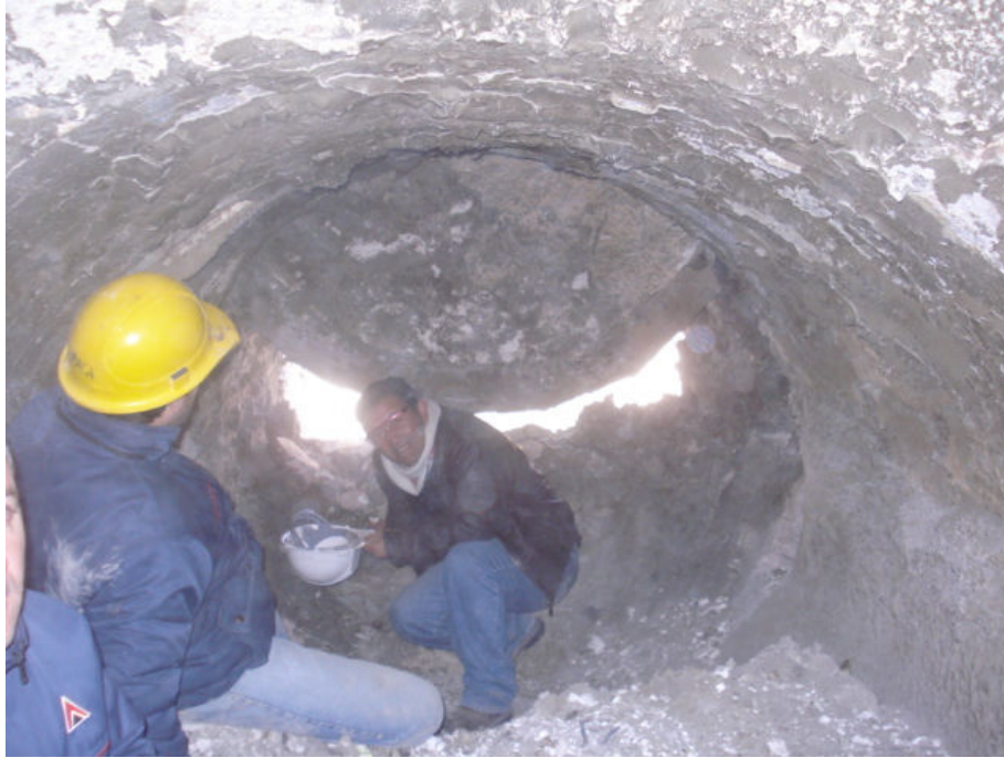
En el corazón de un ducto de aire terciario
